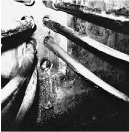
Figura 26.27 Alimentadores subterráneos de MV en un ducto de concreto.
