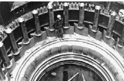
Figura 24.12 En el interior de la caja espiral, un juego de compuertas de mariposa controlan la cantidad de agua que fluye hacia la turbina. (Cortesía de Marine Industrie)
