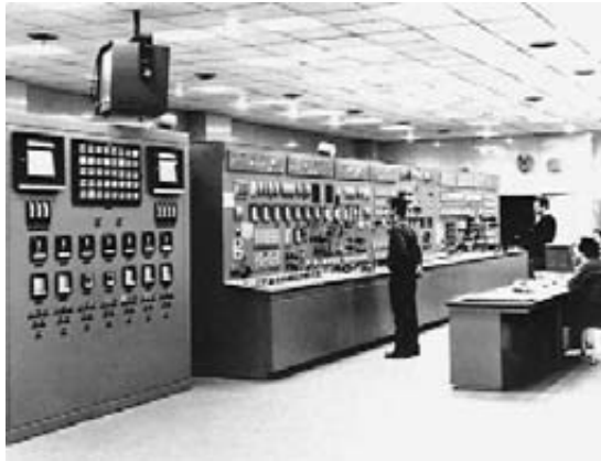
Figura 24.23 Cuarto de control de la unidad generadora de 540 MW. (Cortesía de General Electric)
