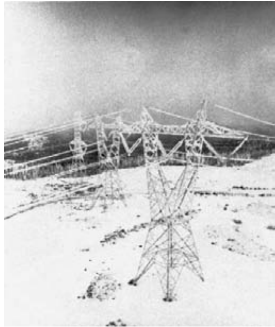
Figura 25.6 Durante el invierno, las torres de acero deben soportar el peso combinado de los conductores y el hielo acumulado. (Cortesía de Hydro-Québec)
