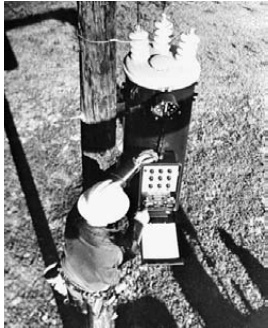
Figura 26.29 Un autotransformador de cambio de toma automático mantiene voltajes constantes en largas línea rurales. (Cortesía de General Electric)
