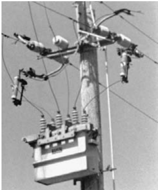
Figura 26.33 Recerrador automático que protege un alimentador trifásico.
