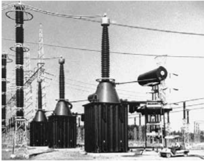
Figura 25.37 Tres grandes reactores monofásicos de 110 Mvar instalados en una subestación para compensar la capacitancia de una línea de transmisión trifásica de 735 kV muy larga. (Cortesía de Hydro-Québec)
